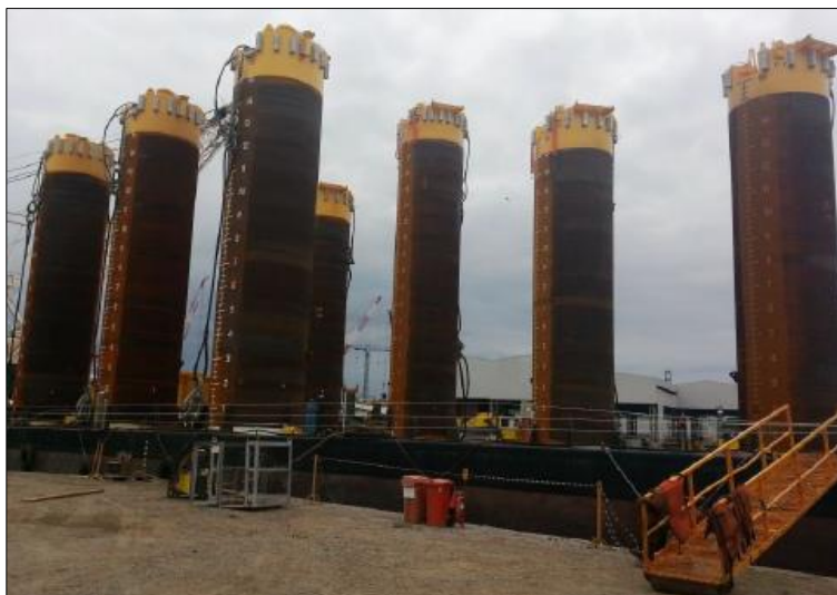
Figura II.2.4.5.1.10-1 – Foto ilustrativa das estacas de sucção.
