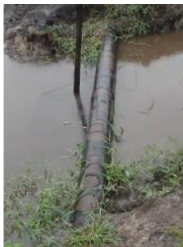
Figura 6 – Trecho aéreo do gasoduto de 10" a 2,5 km da Estação de Fazenda Cedro
