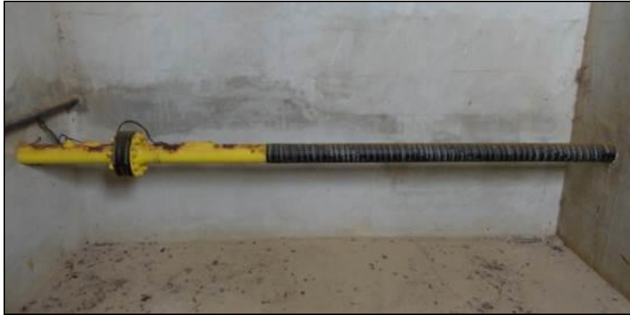
Figura 2 – Trecho aéreo do gasoduto de 4" dentro da caixa de contenção próxima à praia de Urussuquara
