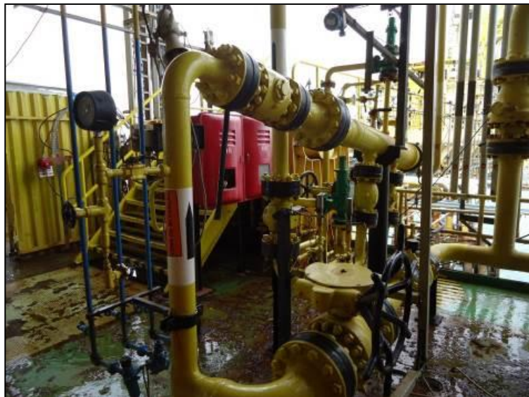
Figura 3 – Recebedor de pig do gasoduto de 4"
