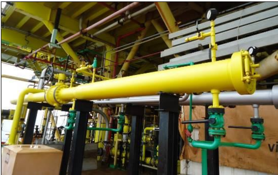
Figura 3 – Lançador de pig do gasoduto de 10"
