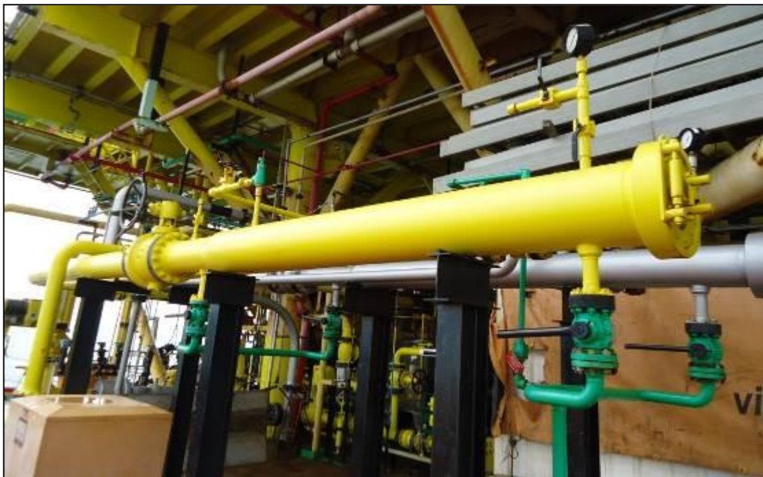
Figura 3 – Lançador de pig do gasoduto de 10" em PCA-02
