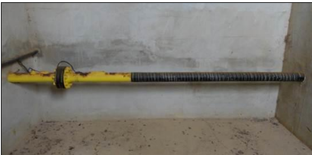
Figura 2 – Trecho aéreo do gasoduto de 4" dentro da caixa de contenção próxima à praia de Urussuquara
