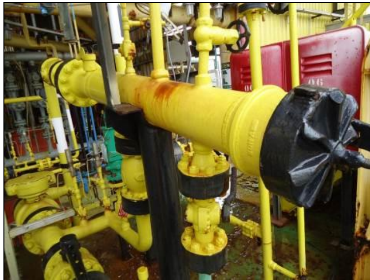
Figura 4 – Recebedor de pig do gasoduto de 4"
