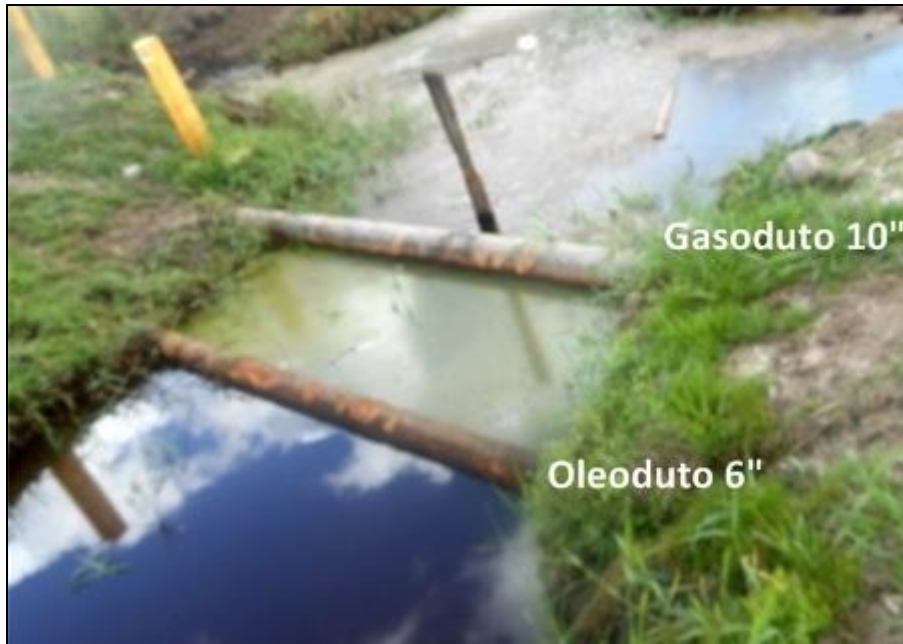
Figura 6 – Trecho aéreo do oleoduto de 6" a 2,5 km da Estação de Fazenda Cedro
