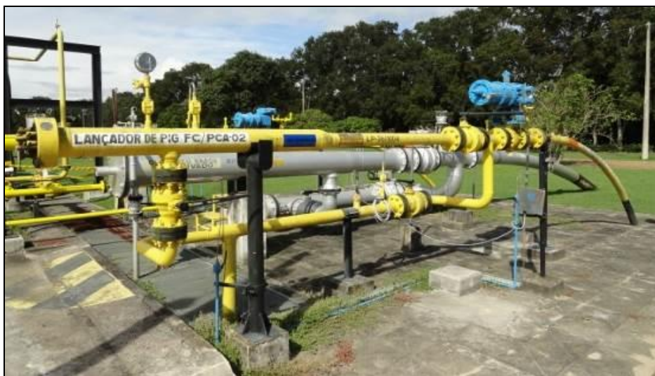
Figura 1 – Lançador de pig do gasoduto de 4"
