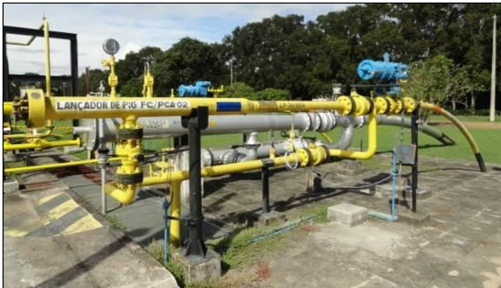
Figura 1 – Lançador de pig do gasoduto de 4"
