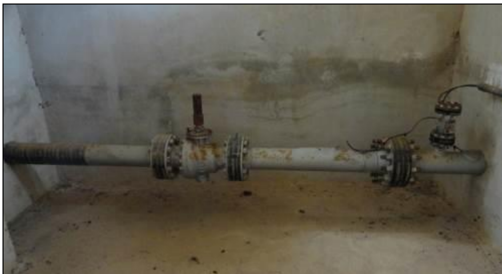
Figura 2 – Trecho aéreo do oleoduto de 6" dentro da caixa de contenção próxima à praia de Urussuquara
