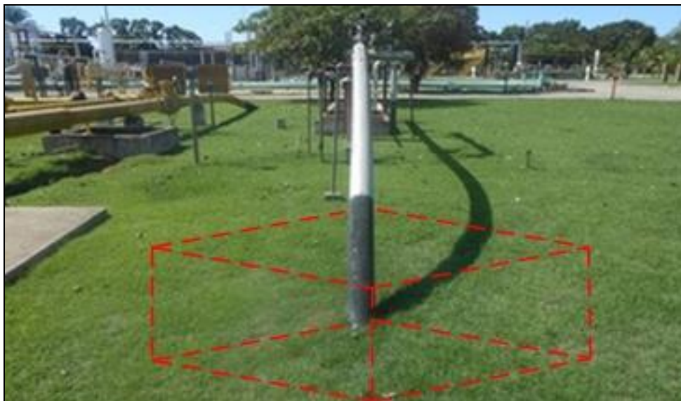
Figura 4 – Local de escavação para seccionamento do oleoduto de 6” na Estação de Fazenda Cedro
