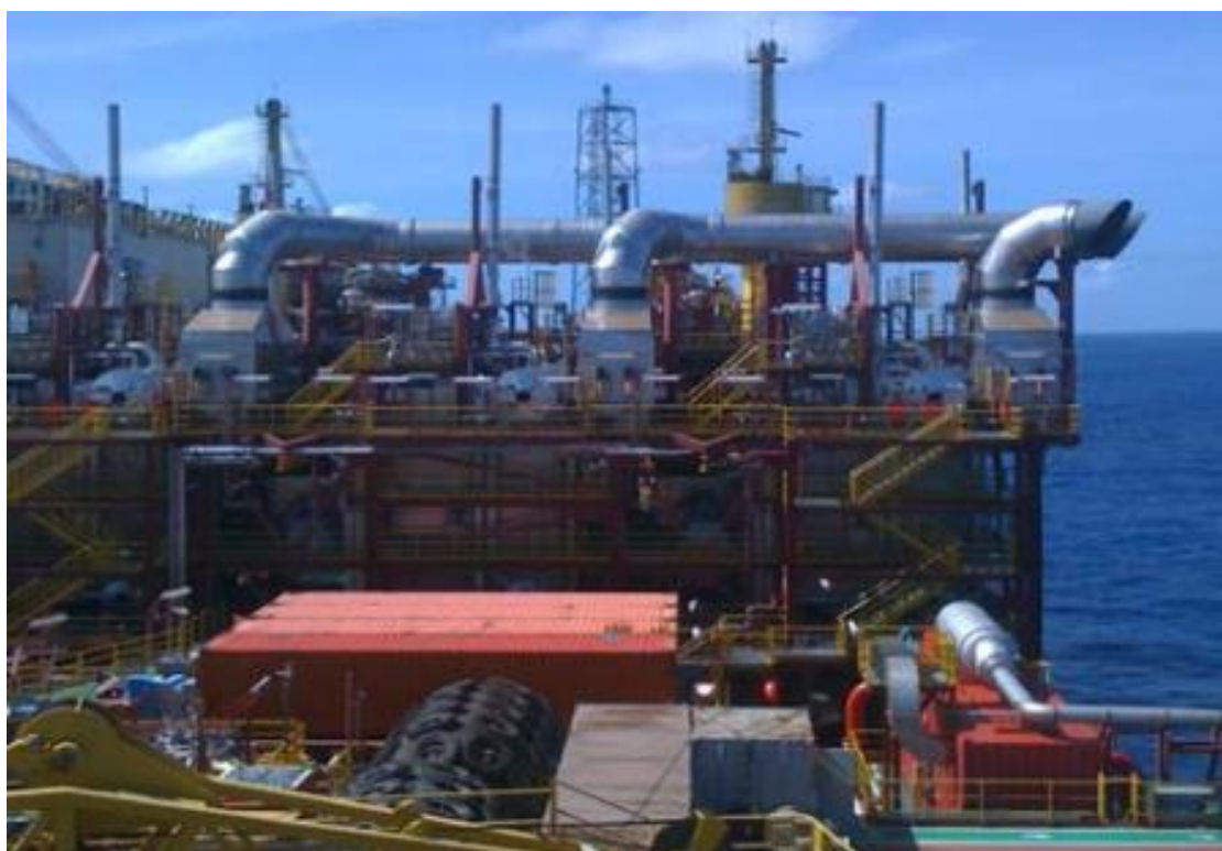
Figura 1.2 Localização das 03 caldeiras da FPSO
