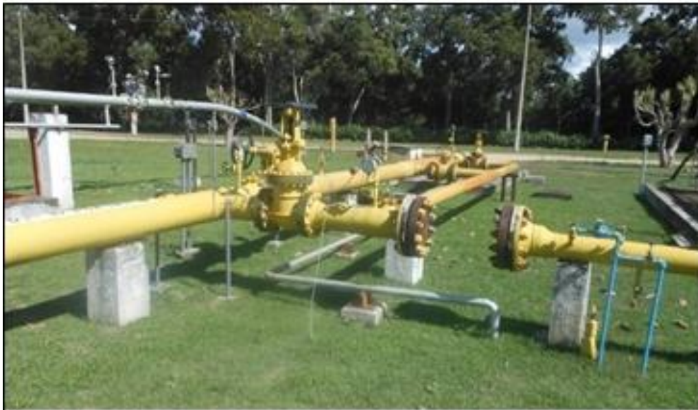
Figura 1 – Recebedor de pig do gasoduto de 10" em FC
