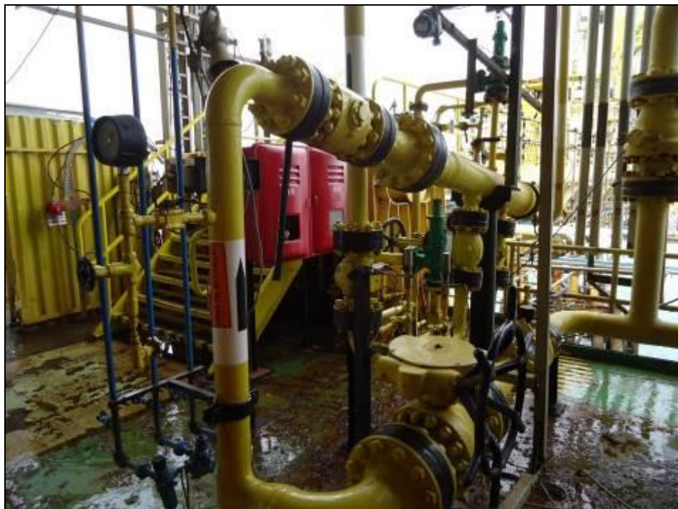
Figura 3 – Recebedor de pig do gasoduto de 4"
