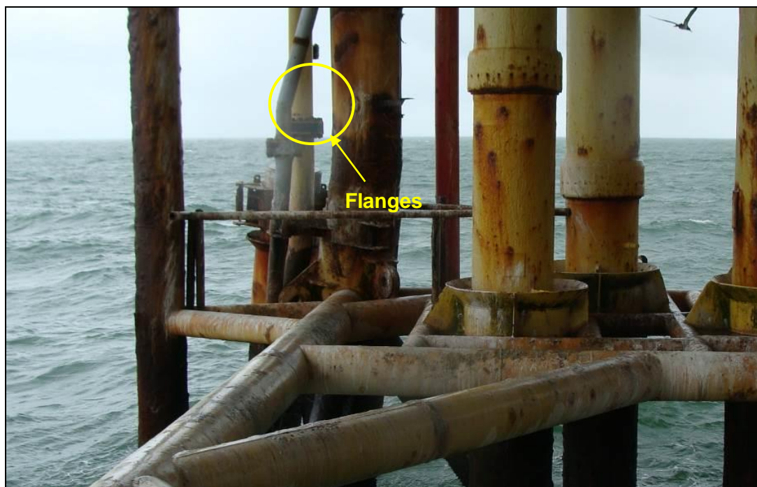
Figura VI.5-1 - Ponto a partir do qual os dutos de 6" e 10" devem estar cimentados
