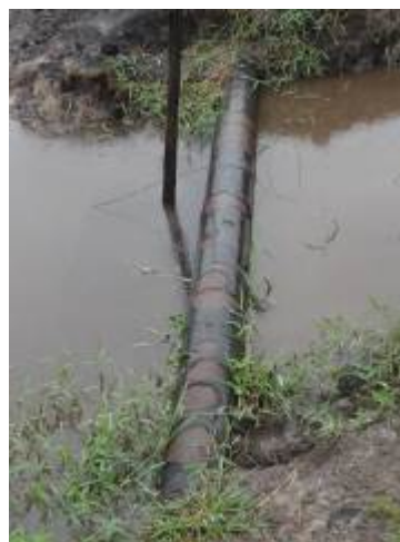
Figura 6 – Trecho aéreo do gasoduto de 10" a 2,5 km da Estação de Fazenda Cedro
