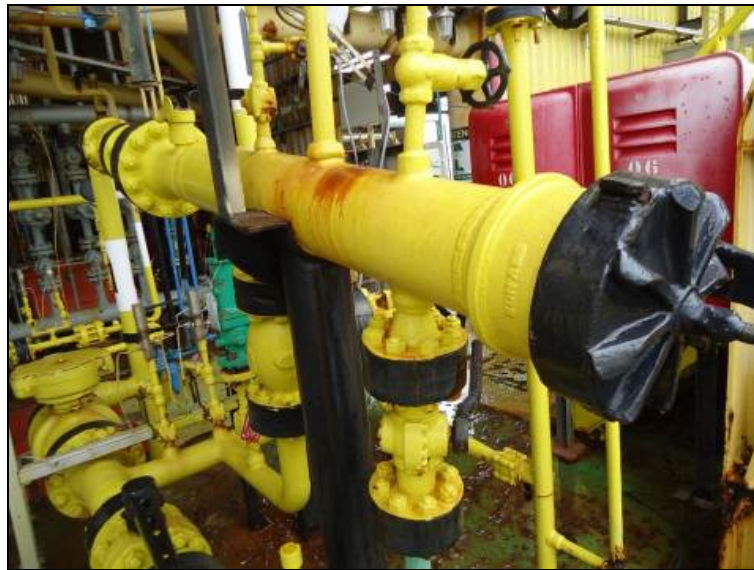
Figura 4 – Recebedor de pig do gasoduto de 4"
