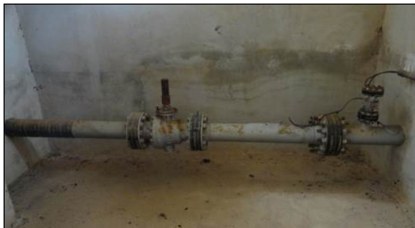
Figura 2 – Trecho aéreo do oleoduto de 6" dentro da caixa de contenção próxima à praia de Urussuquara
