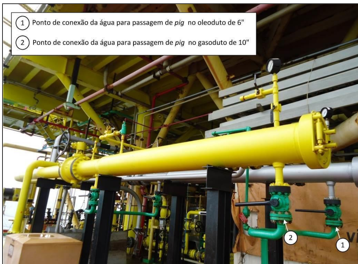
Figura VI-1 - Ponto de entrada da água nos lançadores de pig em PCA-02
