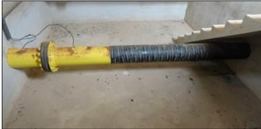
Figura 2 – Trecho aéreo do gasoduto de 10" dentro da caixa de contenção próxima à praia de Urussuquara
