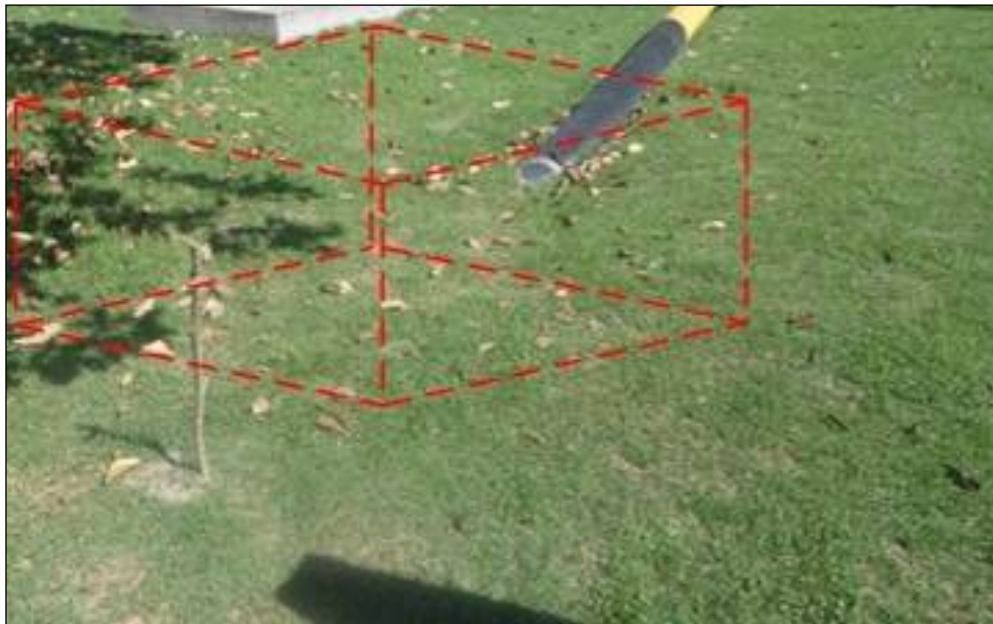
Figura 4 – Local de escavação para seccionamento do gasoduto de 10” na Estação de Fazenda Cedro
