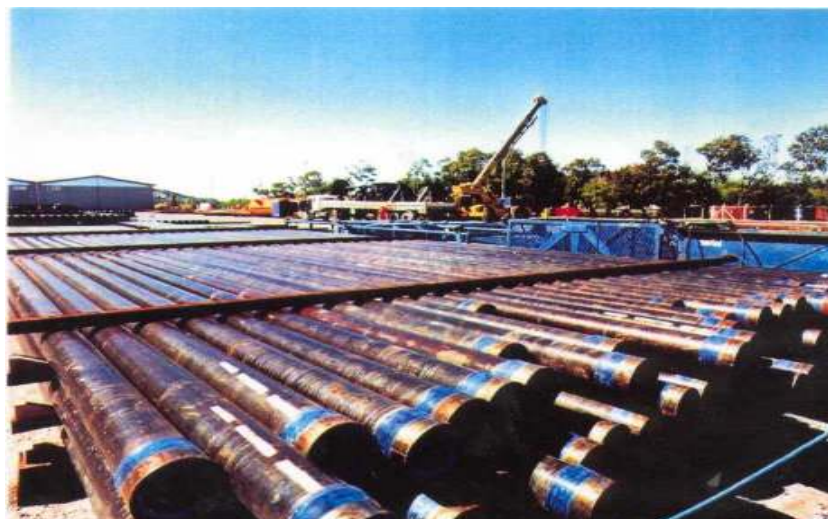
Figura II.2.4-22 - Parque de tubos no CPVV
