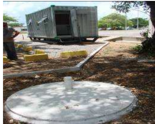
Figura II.7.1.3-2 - Tanque de armazenamento temporário para água oleosa.
