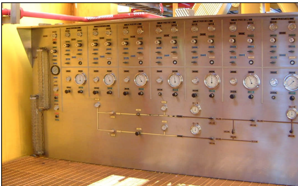
Figura II.2-6: Painel de controle dos poços
