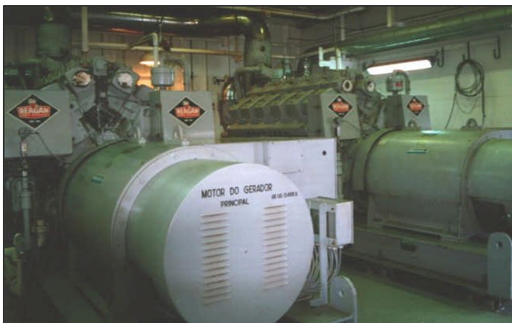
Figura II.2-13: Moto-Geradores Principais Movidos a Gás Natural
