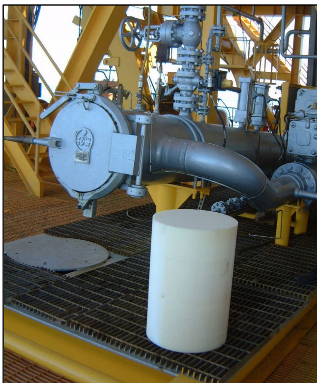
Figura II.2-4: Pig espuma e lançador de pig da Plataforma PMLZ-1.
