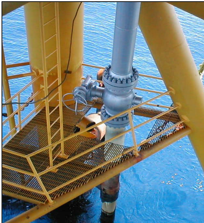
Figura II.2-11: Válvula de emergência (SDV) na saída da Plataforma.
