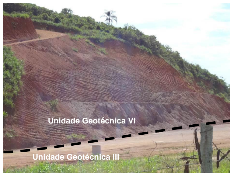
Figura 6.1.5.2-42 - Taludes sem estabilização com gramíneas nas margens da RJ-118. Limite das Unidades Geotécnicas VI e III (UTM 736.209mE / 7.460.722mN).
