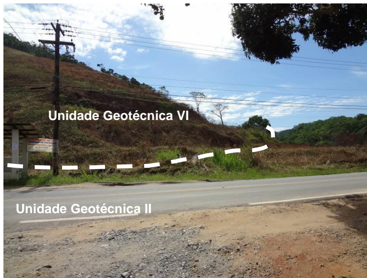
Figura 6.1.5.2-52 - Limite das Unidades Geotécnicas VI e II nas margens da RJ-118, com presença de taludes instáveis dentro da AEL (UTM 733.780mE / 7.463.485mN).
