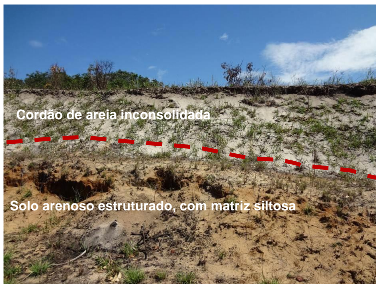
Figura 6.1.5.2-4 - Perfil de alteração do solo no contato entre as areias inconsolidadas e solo arenoso estruturado com matriz siltosa, próximo a Estação de Válvulas no município de Maricá (UTM 739.375mE / 7.461.650mN). Fonte: Habtec Mott MacDonald, 2012.
