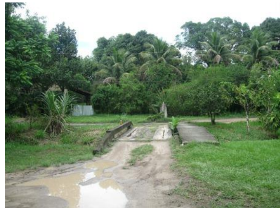
Figura 6.3.2.2-53 - Rua interna em condição precária, Picos.
