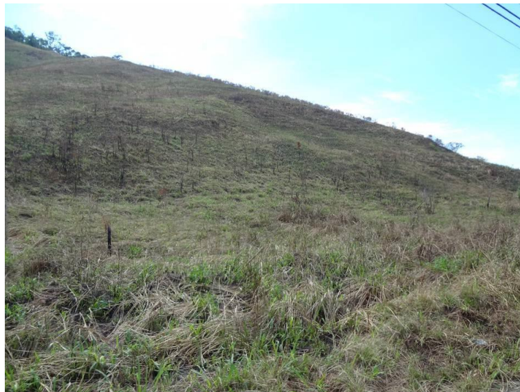
Figura 6.1.5.2-50 - Trecho de encosta na Unidade Geotécnica VI que apresenta processos de instabilidade para ocorrência de movimentos de massa nas proximidades da AEL (UTM 733.780mE / 7.463.485mN).
