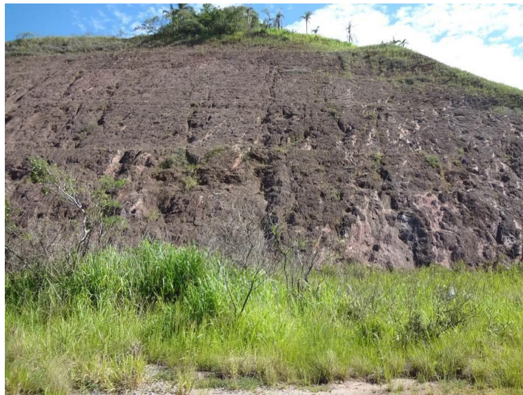
Figura 6.1.5.2-29 - Argissolo Amarelo sobre gnaisses bastante alterados do Complexo Paraíba do Sul, nas margens da RJ-118 (736.721mE / 7.460.450mN).
