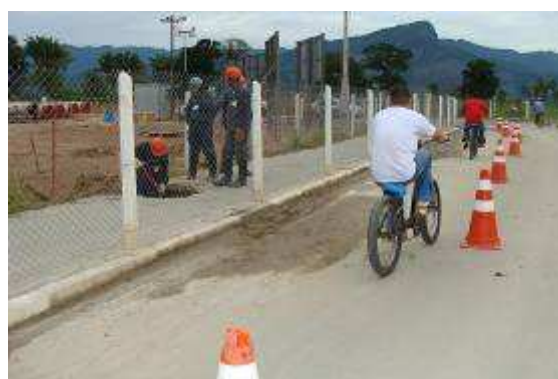
Figura IV-2 – Desvio da ciclovia recebeu sinalização adequada.
