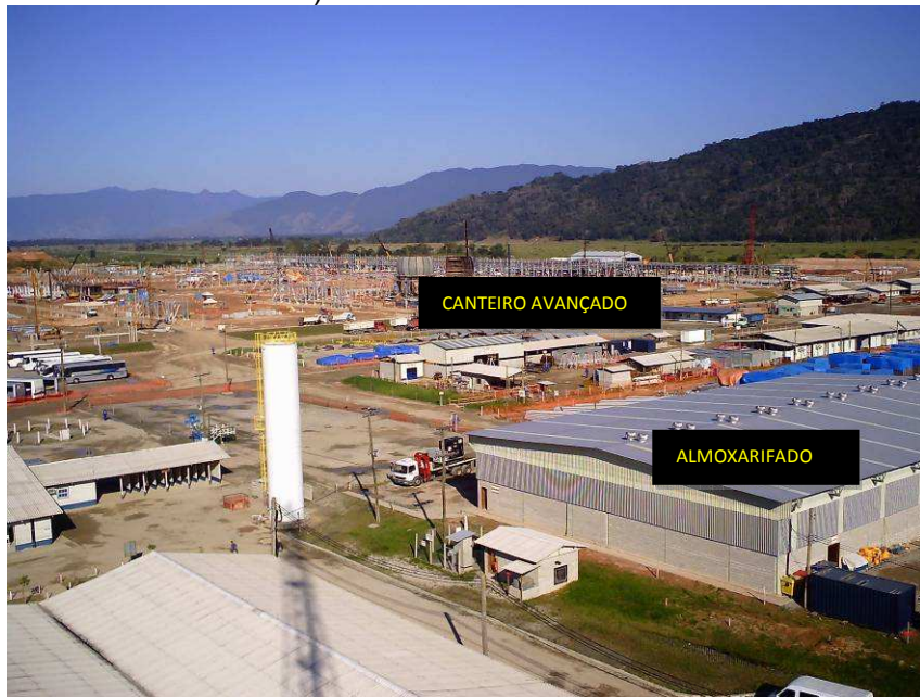
Figura III.2-2 Vista aérea do canteiro de obras– Identificação dos centros de apoio (Imagem com finalidade ilustrativa).
