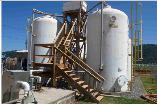
Figura III.12 Sistema de Tratamento de Efluentes – ETE (EK).
