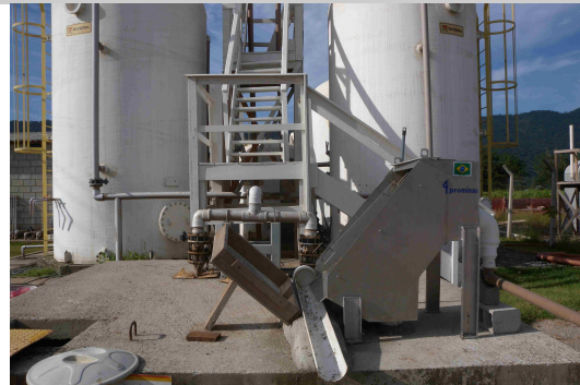
Figura III.13 Sistema de Tratamento de Efluentes – ETE (EK)
