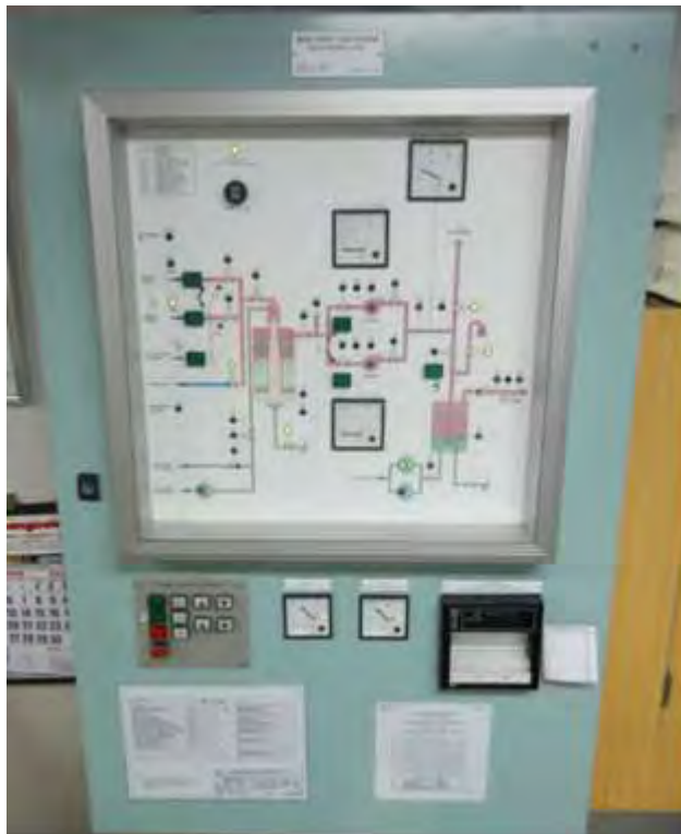
Figura II.2.4-49 - Painel do sistema de controle de gás inerte.
