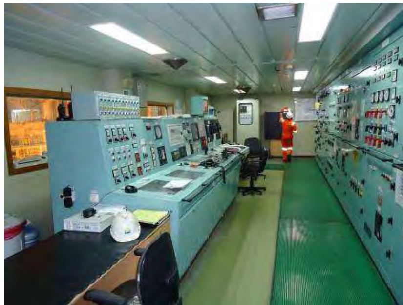
Figura II.2.4-37 - Centro de controle de máquinas e utilidades.
