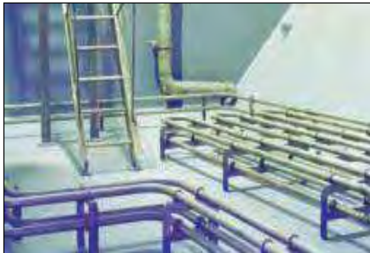
Figura II.2.4.21 - Serpentinhas de passagem de vapor para aquecimento da carga nos tanques de armazenamento.
