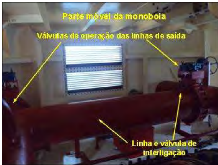
Figura II.2.4-32 - Ilustração da parte móvel da monoboia com as válvulas de saída.
