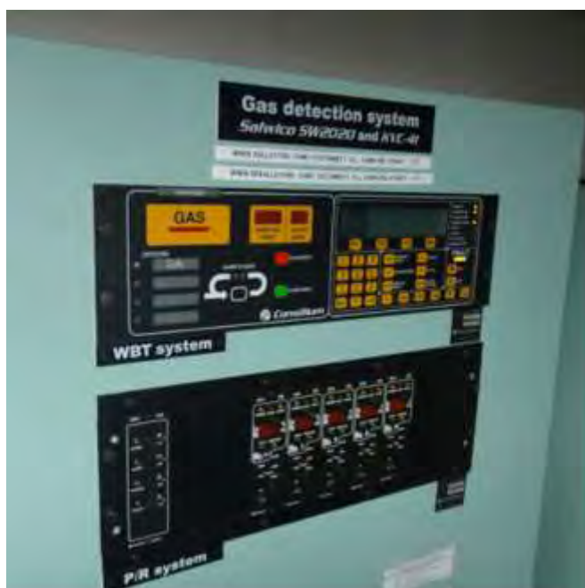
Figura II.2.4-50 - Painel do sistema de detecção de gás.
