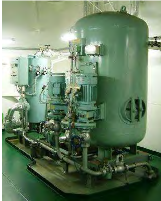
Figura II.2.4-27 - Ilustração de uma unidade geradora de água potável.
