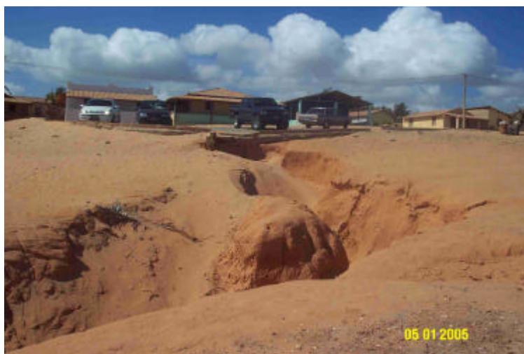
Figura II.5.3-14: Processos erosivos na Praia de Estevão, Aracati. Fonte OCEANSATPEG (2005)
