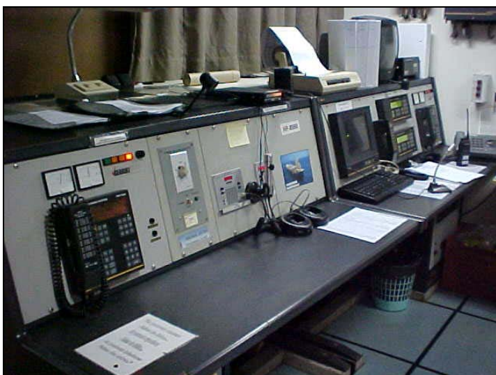
Figura 2.4-15: Vista da sala de rádio da unidade.
