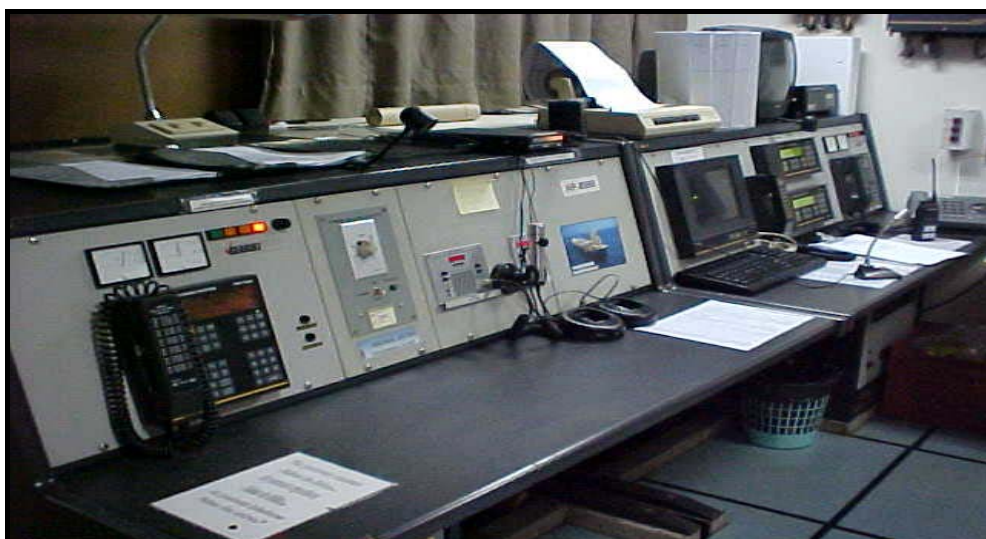
Figura 2.4-2: Vista da sala de rádio da unidade.
