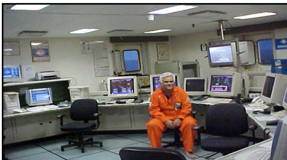
Figura 2.4-6: Vista da sala de controle da unidade.
