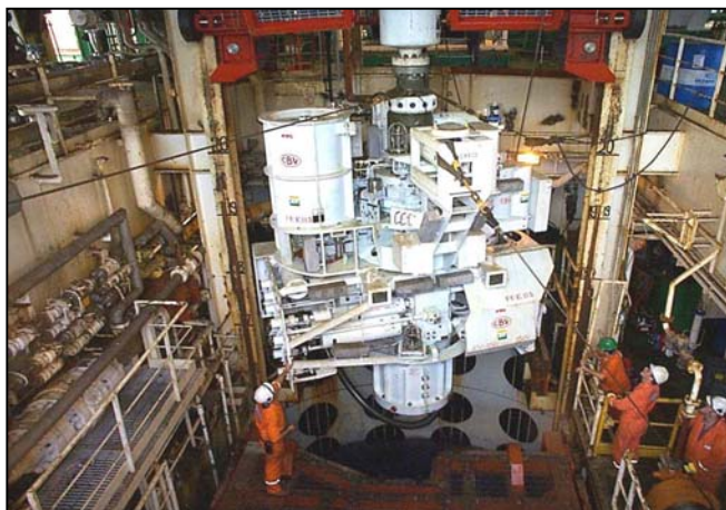
Figura 4.1.1-1: Árvore de Natal Molhada (ANM) no interior do FPSO Seillean.
