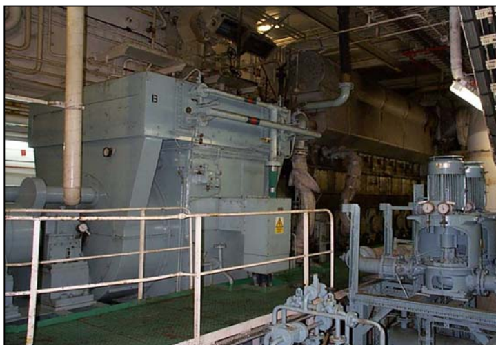
Figura 9.7-1: Um dos geradores principais da unidade.
