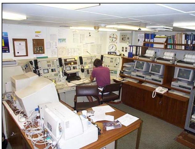
Figura 6-2: Vista da sala de rádio da unidade.
