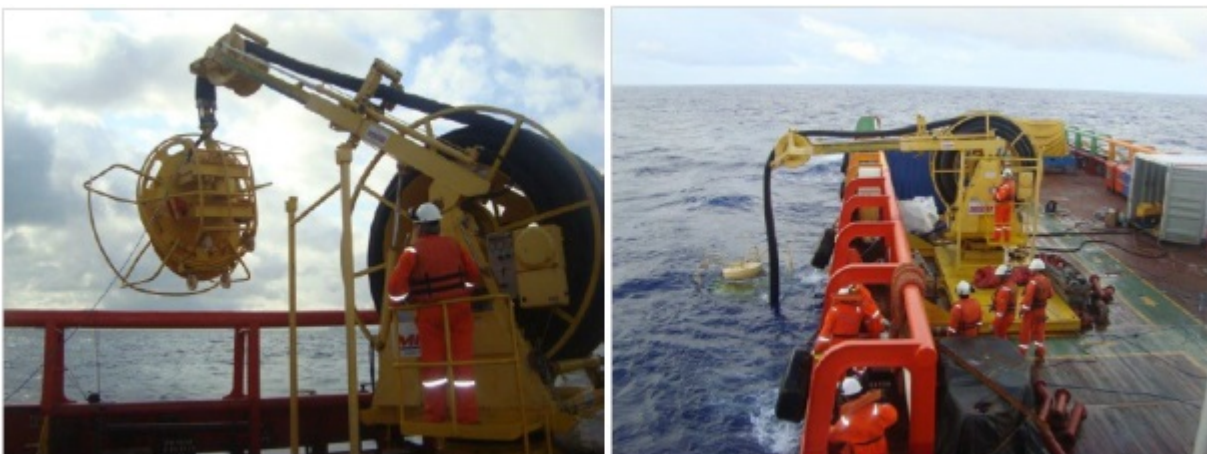
FIGURA 6 - Lançamento de Skimmer, realizado no dia 09 de novembro de 2013 pela embarcação MV Magé.
