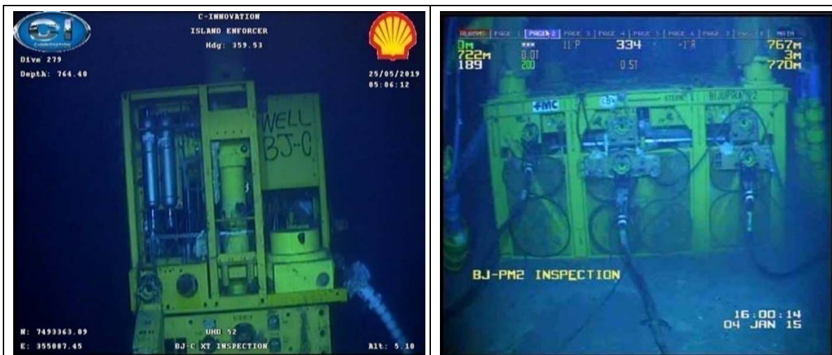
Figura 3.5.1.2 – Árvore de natal BJ-CX-tree à esquerda e Manifold de produção de Bijupirá à direita
