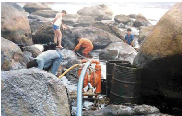
7.7. Bombeamento a vácuo de empoçamentos em costões heterogêneos. Banco de imagens da CETESB
