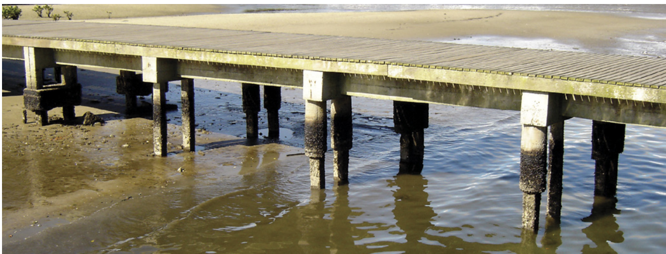
8.7. Superfície de pilar de molhe contaminado com óleo, Paranaguá, PR. Banco de imagens da CETESB
