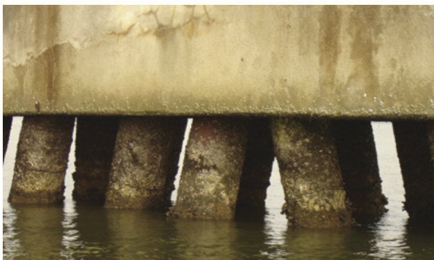
8.5. Pilar de molhe onde se observa a presença de organismos, Santos (SP). Banco de imagens da CETESB
