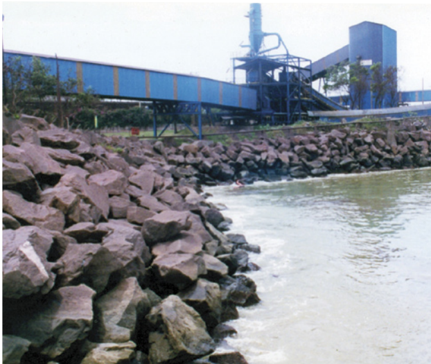
8.8. Região inferior de enrocamento com presença de óleo. Terminal da Companhia Vale do Rio Doce (ES). Lopes, Carlos Ferreira
