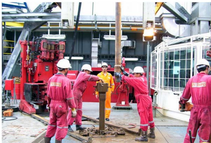
FIGURA II.3.1.2 – Plataforma com mesa rotativa de uma sonda de perfuração marítima.
