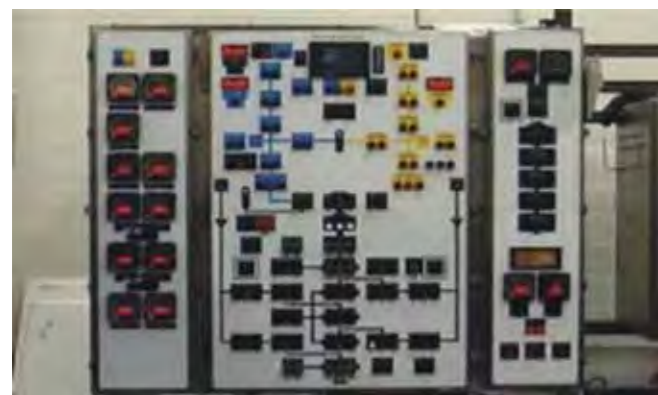
Painel de controle do BOP na Plataforma
