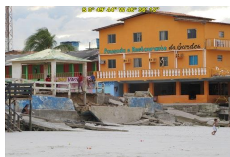
Rampa de acesso à praia danificada
