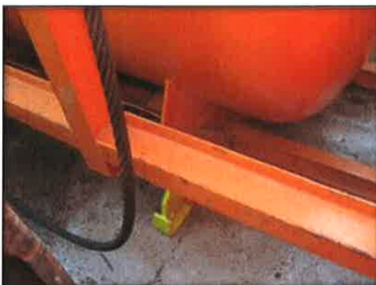
Figura 17 - Tanque com óleo usado em área sem contenção
