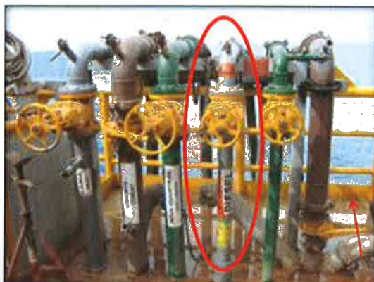
Figura 21 – Tubulação de recebimento de diesel com válvula, em área contida
