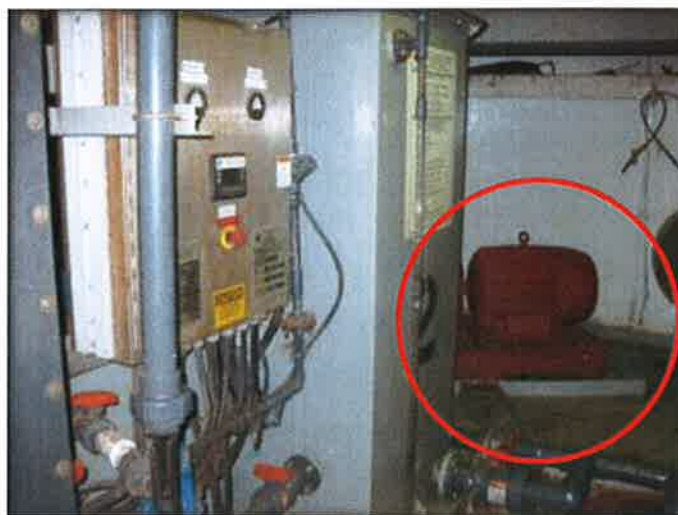
Figura 36 - Bomba de Incêndio
