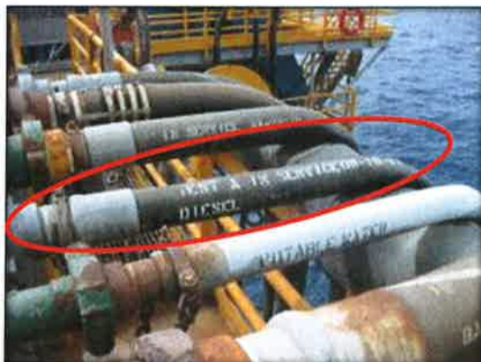
Figura 20 – Tomada e Mangote de recebimento de diesel
