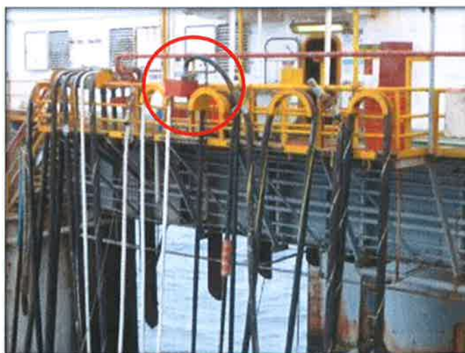
Figura 22 - Bocal do Mangote de recebimento de diesel repousando em bandeja de contenção
