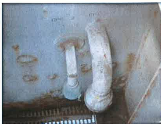
Figura 10 - Vents dos Tanques CPC2 e CPT3
