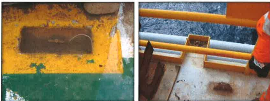
Figura 13 e 14 - Drenos do sistema de Drenagem Aberta
