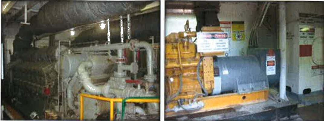
Figura 37 - Um dos geradores principais | Figura 38 - Gerador de emergência
