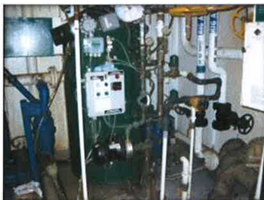
Figura 19 - Separador de Água e Óleo
