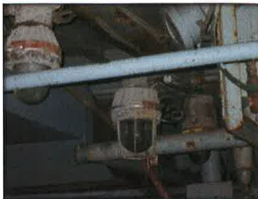
Figura 8 - Alarme, respectivamente, na sala de peneiras
