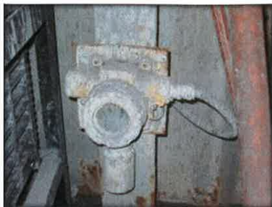
Figura 7 - Detector de H 2 S na sala de peneiras
