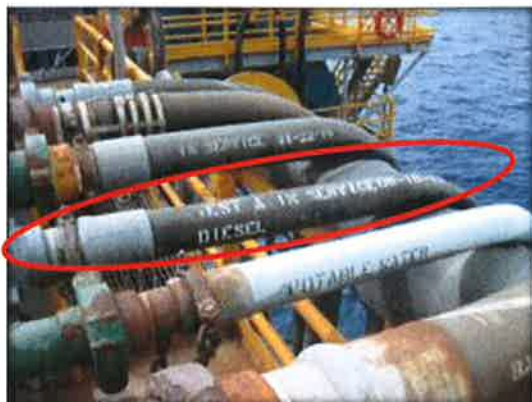
Figura 20 – Tomada e Mangote de recebimento de diesel
