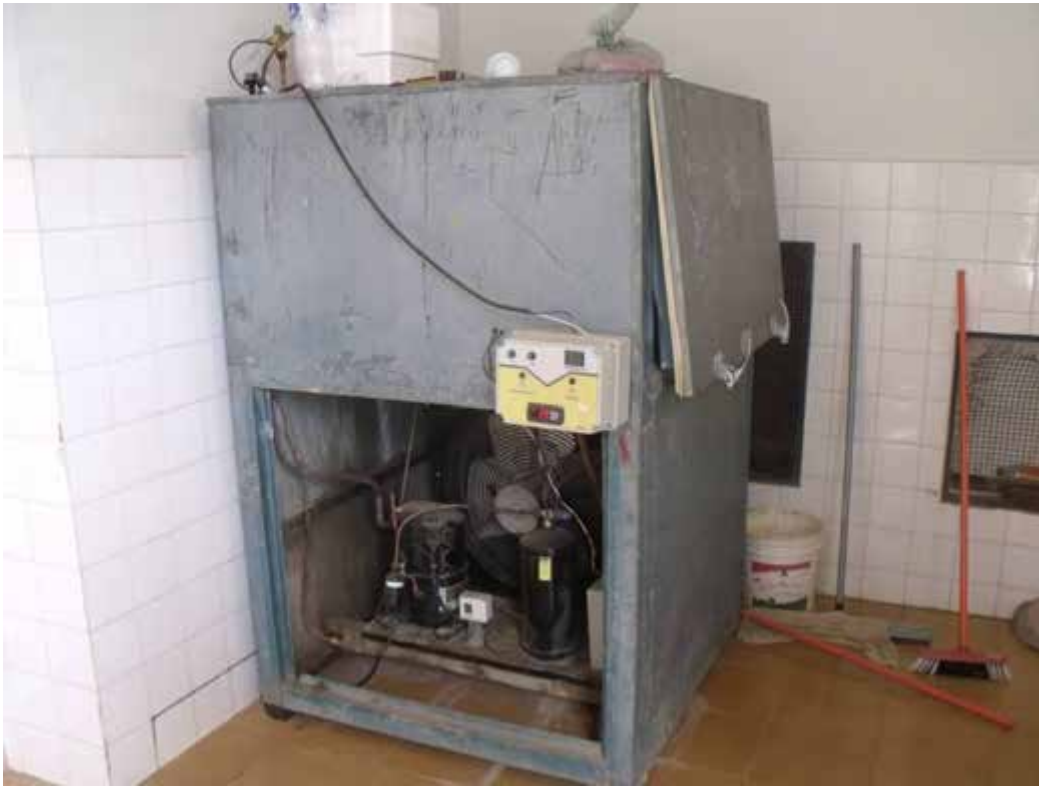
Foto 72: Refrigerador da Sede da Colônia de Pescadores
