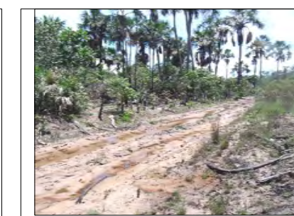
07- TRECHO COM ACUMULO DE ÁGUA PROVENIENTE DE VEREDAS E CHUVAS (À ÉPOCA DO CAMPO). COORD. 511.006 E - 8.385.379 S
