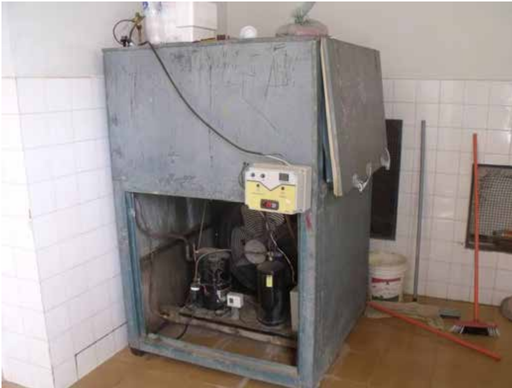
Foto 72: Refrigerador da Sede da Colônia de Pescadores
