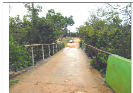
10- ESTRADA ENTRE BONITO DE MINAS E EIXOS - PONTE DE ALVENARIA SOBRE O CÓRREGO CATOLÉ, LOCAL DE LAZER BALNEÁRIO DO CATULÉ. COORDENADA 519.089 E - 8.309.630 S
