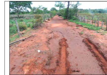
03- ATOLEIROS SE FORMAM DEVIDO A CARACTERÍSTICA ARGILOSA DE ALGUNS TIPOS DE SOLO DA REGIÃO EM PERÍODOS CHUVOSOS. COORDENADA 528.150 E - 8.408.811 S
