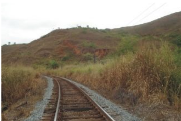
FOTO 49 - PROCESSO EROSIVO EM CORTE DE ESTRADA DE FERRO
