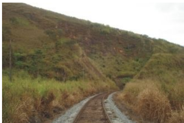
FOTO 50 - PROCESSO EROSIVO EM CORTE DE ESTRADA DE FERRO
