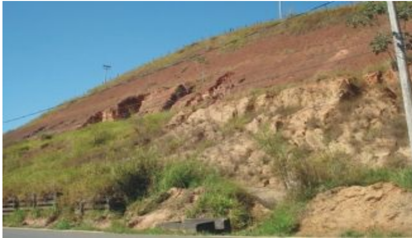
FOTO 51 - PROCESSO EROSIVO EM TALUDE DE ESTRADA
