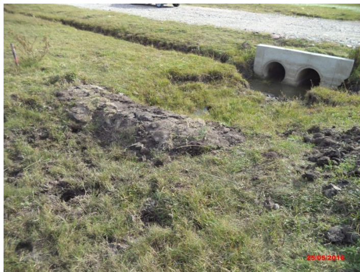
FIGURA 31. Fechamento da saída de água da unidade amostral P18 para o bueiro da estrada de acesso aos aerogeradores na AID dos PE Minuano I e II. Décima primeira campanha de monitoramento (novembro/2015).
