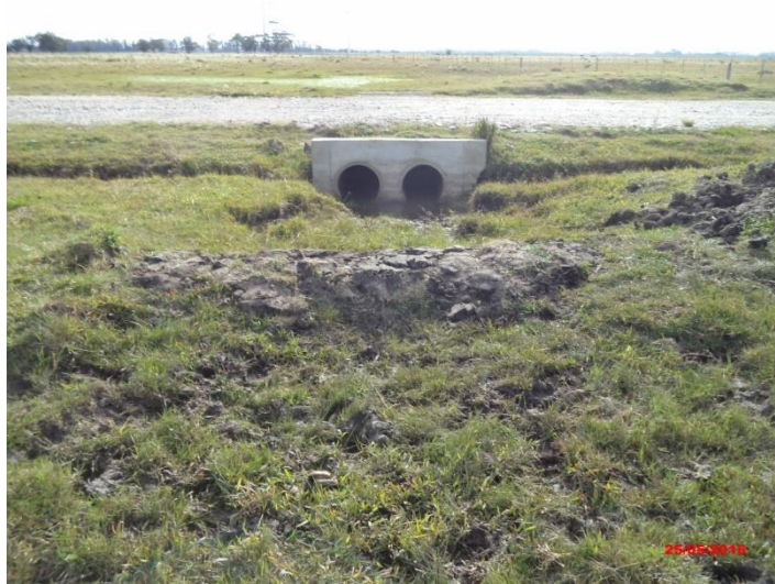
FIGURA 32. Fechamento da saída de água da unidade amostral P18 para o bueiro da estrada de acesso aos aerogeradores na AID dos PE Minuano I e II. Décima primeira campanha de monitoramento (novembro/2015).
