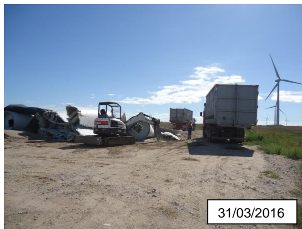
FIGURA 12 – OPERAÇÃO DE CORTE E DESCARACTERIZAÇÃO DAS PÁS AVARIADAS, UG-11, MINUANO I; Fotografia: Paula D. Cardoso
