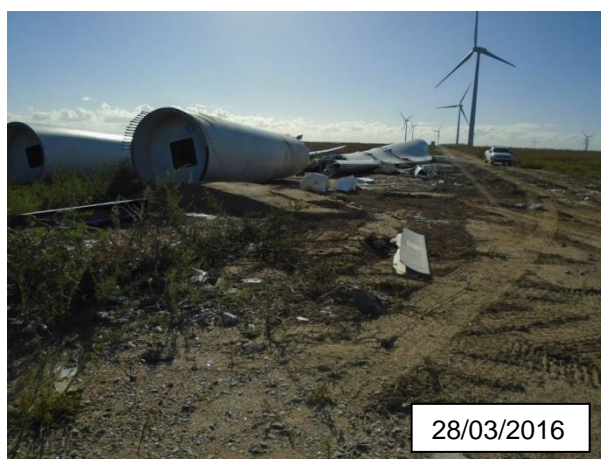
FIGURA 10 – OPERAÇÃO DE CORTE E DESCARACTERIZAÇÃO DAS PÁS AVARIADAS, UG-11, MINUANO I; - Fotografia: Paula D. Cardoso
