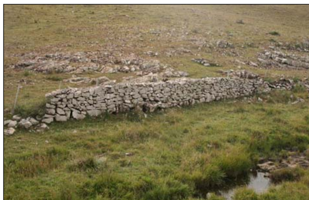
Figura 211- Muro de pedra que faz divisa entre as propriedades. Construção comum na região que pode servir de esconderijos a fauna de répteis, na área de influência da futura CGE Fronteira Sul, Santana do Livramento, Rio Grande do Sul. Maio de 2012.
