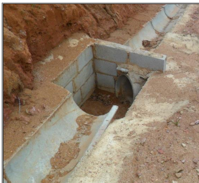
Figura 7: Caixa de sedimentação intercalando a drenagem com canaleta de concreto.
