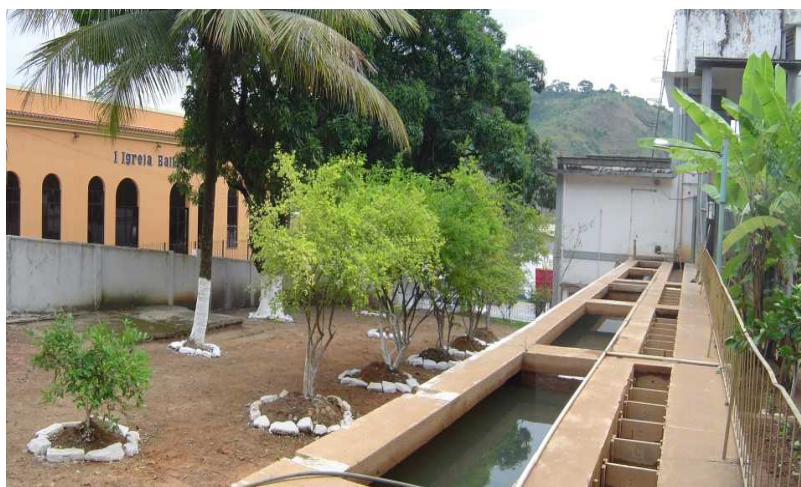
FIGURA 2.68 ESTRUTURAS DE TRATAMENTO DA ETA DE SAPUCAIA
