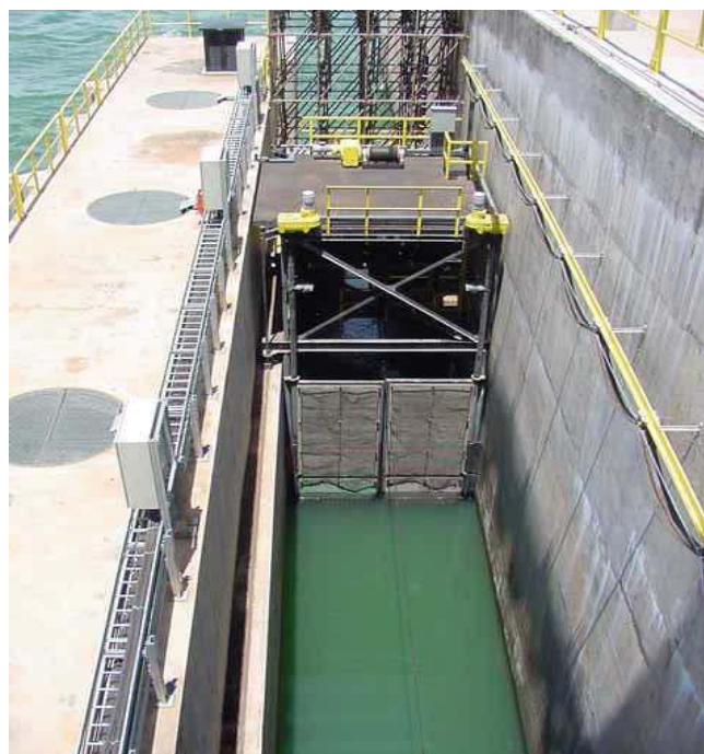
FIGURA 4 UHE PORTO PRIMAVERA – ELEVADOR DE PEIXES – ESTAÇÃO DE BOMBEAMENTO (À ESQUERDA), CANAL DE ENTRADA E GRADE CONFINADORA FECHADA
