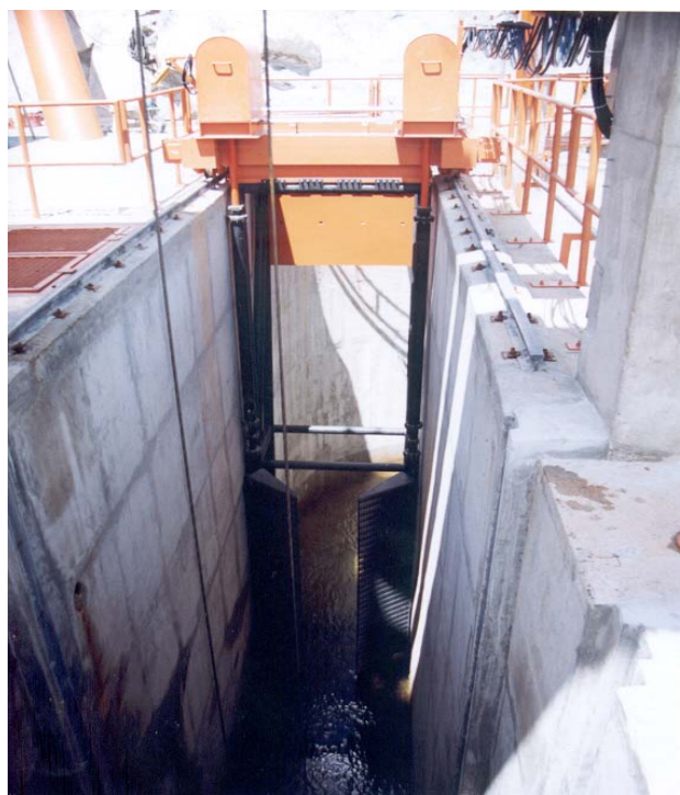
FIGURA 3 UHE SANTA CLARA – SCTP – CANAL DE ENTRADA E GRADE CONFINADORA ABERTA
