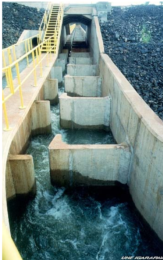
FIGURA 16 UHE IGARAPAVA – ESCADA DE PEIXES – ESCOAMENTO NOS TANQUES
