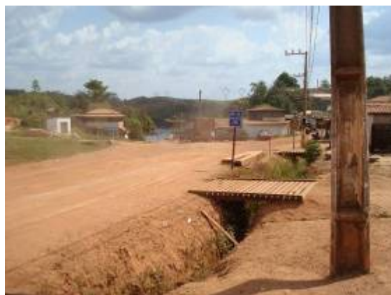
FIGURA 5.3.2.3- 4 – As valetas de drenagem sofrem processo erosivo e não contam com qualquer proteção
