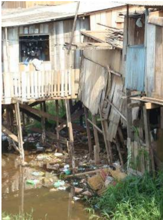
FIGURA 5.1.7.2- 8 –Edificações precárias e lixo acumulado
