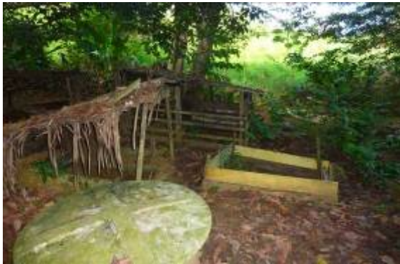
FIGURA 4.3.2.2- 5 - Abastecimento de água por gravidade, feito pelos moradores da comunidade. Atende pequena parte da comunidade
