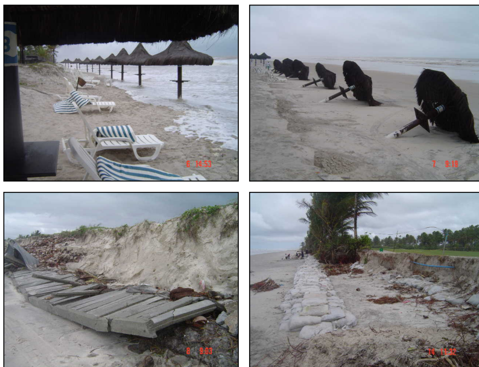
Figura 1 - Impactos da erosão da linha de costa na propriedade do Hotel Ilha de Comandatuba. (Fonte: DOMINGUEZ, 2008).
