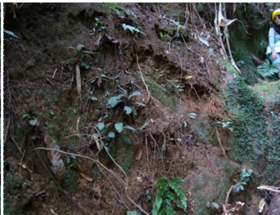
Figura 5.1-98 - Maciço granítico alterado localizado na linha de drenagem leste do emboque sul do túnel.
