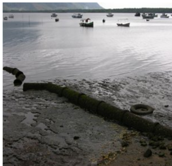
Figura 5.1-138 - Canalização de águas servidas para a Praia do Saco de Dentro, localizada do outro lado da estrada.
