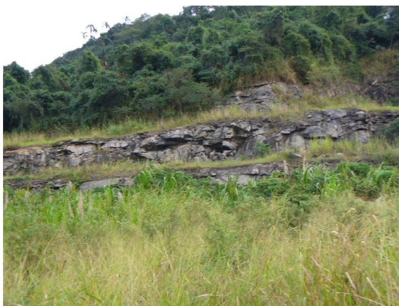
Figura 5.1-50 - Pedreira desativada no Porto de Sepetiba com fraturas de alívio sub-horizontais.
