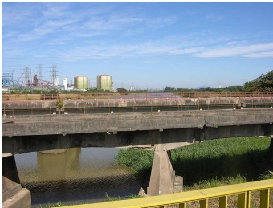
Figura 5.1-141 - Ponte da CSA sobre o canal de São Francisco – visão ao Sul, com instalações da CSA.
