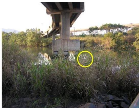
Figura 5.1-132 - Mangue dentro do complexo Portuário, no detalhe manilha de dreno do canal que passa ao atrás do pátio da CSN.
