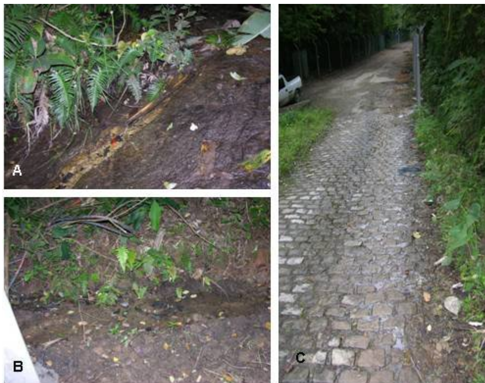
Figura 5.1-136 – Afloramento de água na bacia 8, vista no corte da estrada José Miranda Oliveira (A). O escoamento da drenagem é desviado para uma vala (B) e dispersando-se pela estrada (C).
