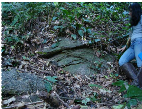
Figura 5.1-95 - Blocos de granito em processo de esfoliação no emboque sul do túnel.
