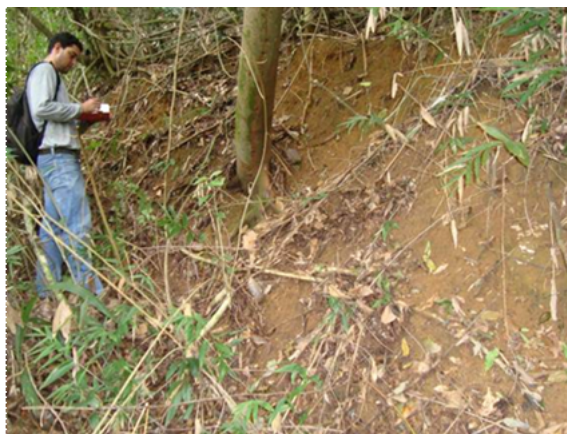
Figura 5.1-101 - Solo coluvionar espesso que ocorre no emboque norte. Este ponto está localizado na antiga estrada da Ilha da Madeira que poderá ser utilizada para acesso às sondagens do túnel.
