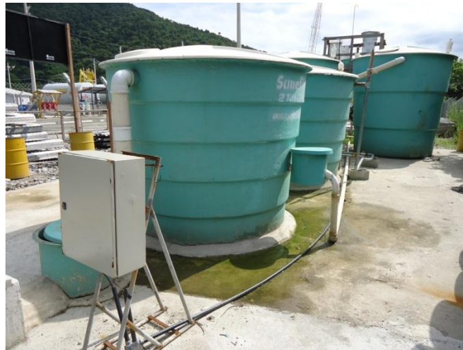
Figura 1 – Estação de Tratamento de Esgoto Doméstico localizada no Canteiro Norte.
