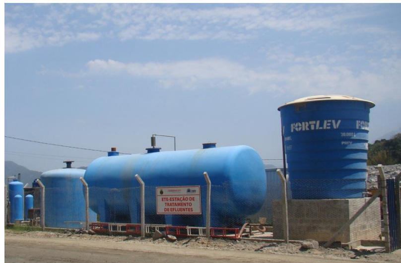
Figura 2 - Estação de Tratamento de Esgoto Doméstico localizada no Canteiro Sul
