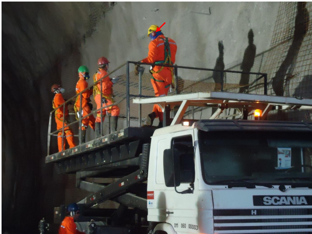
Figura 3 – Integrantes realizando atividades dentro do túnel utilizando corretamente os EPIs necessários para prevenção de danos auditivos.
