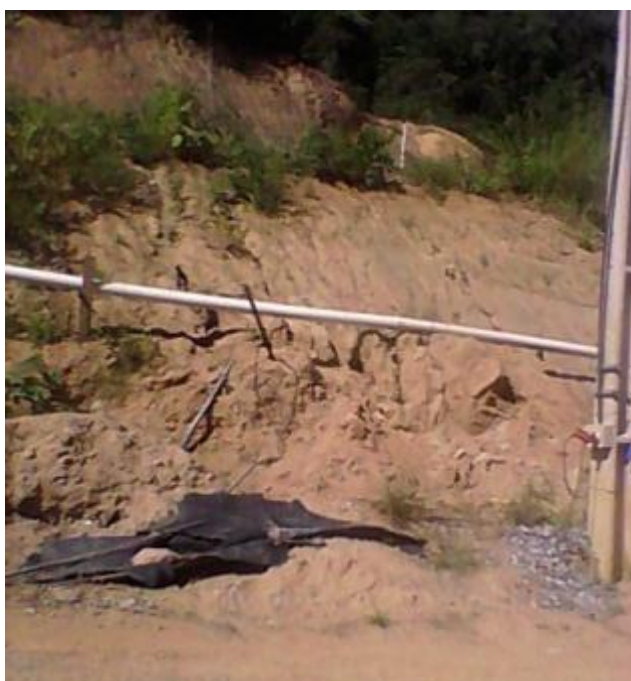
Figura 14 - Soterramento natural do Processo Erosivo 3.6 identificado no monitoramento de agosto de 2012.
