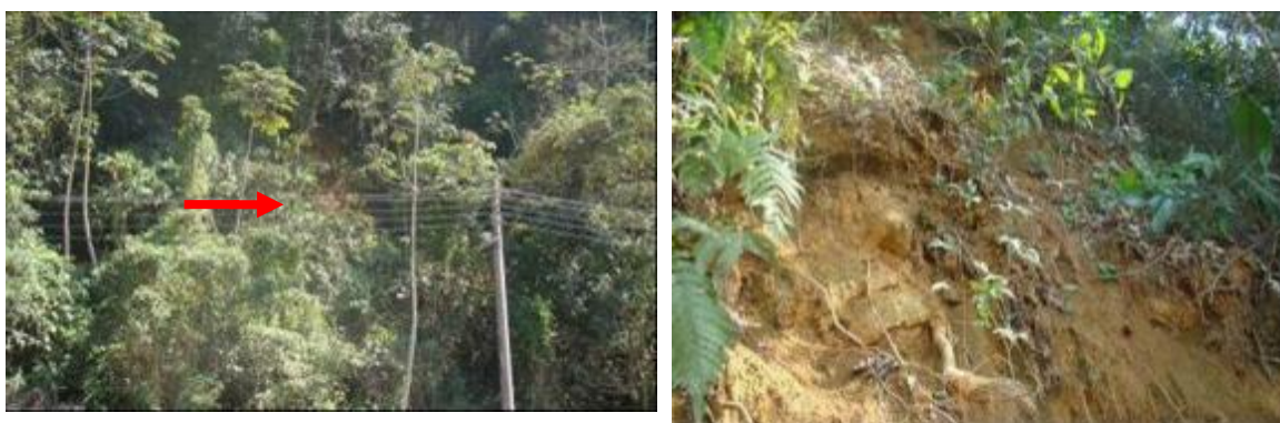
Figura 2 - Identificação do processo erosivo.
