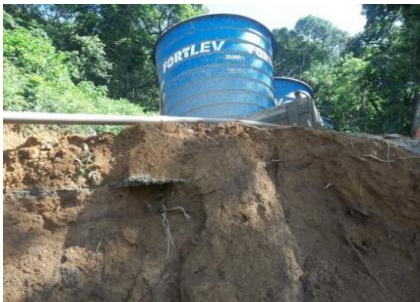
Figura 26 - Queda de solo na parede do talude identificada no monitoramento de janeiro de 2012.
