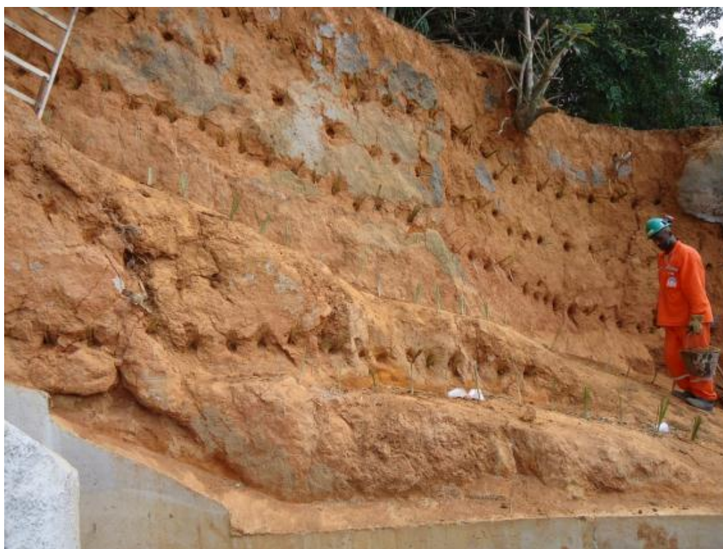
Figura 21 – Mitigação da feição com plantio de mudas de capim-Vetiver em Junho de 2012.
