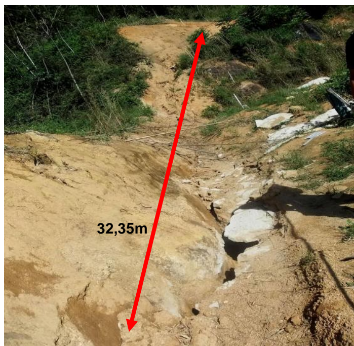
Figura 10 – Visão parcial da continuidade da extensão da fenda do processo erosivo 3.3.
