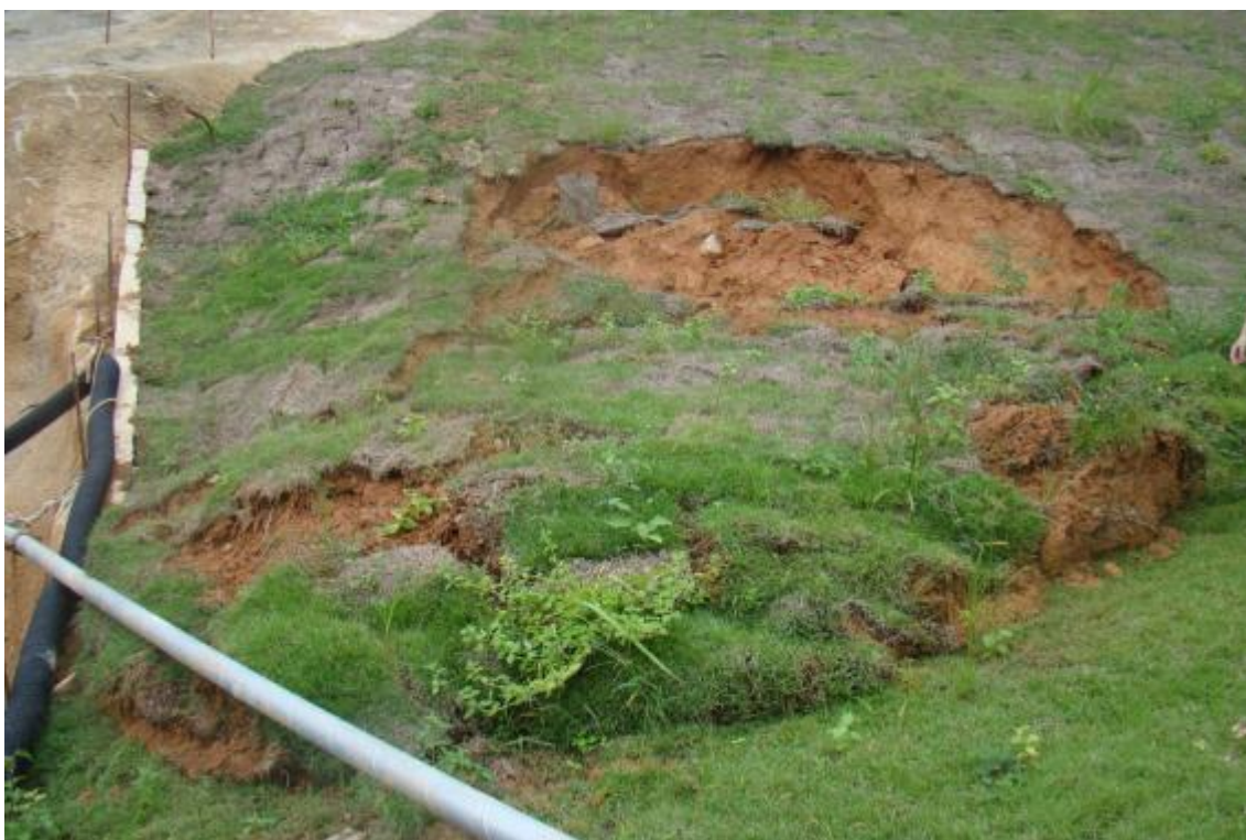
Figura 30 – Visão do escorregamento (Feição Erosiva 13) no Emboque Norte do Túnel detectado em junho de 2012.
