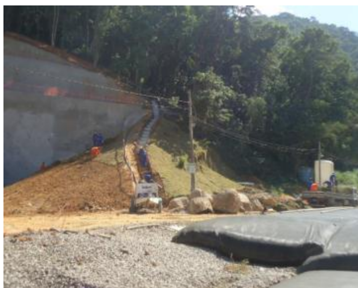
Figura 25 – Visão geral do processo erosivo mitigado em Março de 2012.
