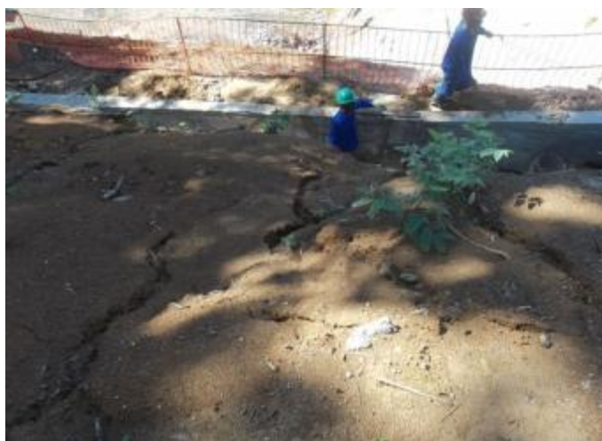
Figura 27 - Rachaduras presentes na superfície superior do talude visualizadas em janeiro de 2012.
