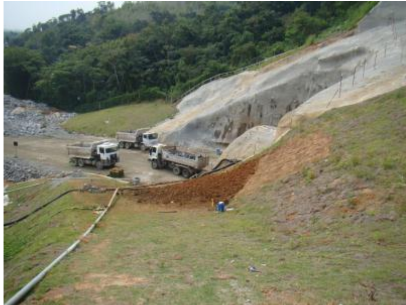
Figura 33 - Visão geral da área do escorregamento após a construção dos muros de arrimo, nivelamento do talude e início de replantio com gramíneas em Julho de 2012
