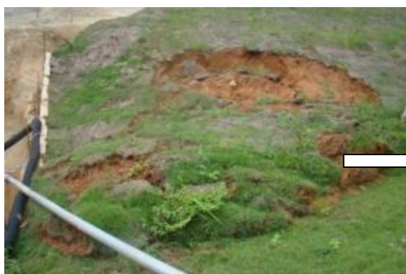
Figura 43 – Processo erosivo detectado em campo.
