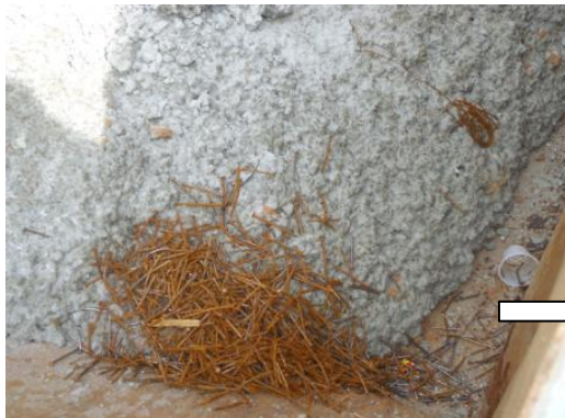
Figura 39 – Descarte incorreto de Resíduos Metálicos em caçamba destinada a Resíduos de Construção.
