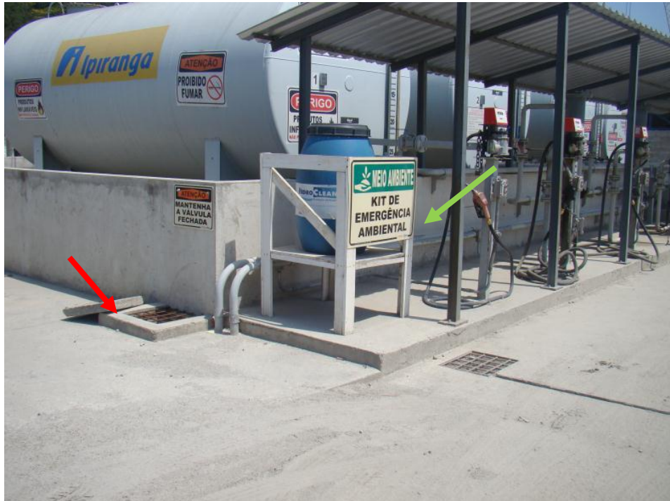
Figura 12 – Destaca-se em vermelho a válvula da bacia de contenção e em verde o kit de emergência ambiental.
