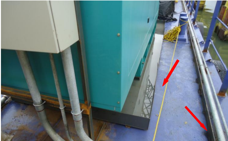
Figura 16 – Vista detalhada das medidas preventivas adotadas nas balsas: bandejas de contenção sob os geradores e trincanis cercando toda a balsa.
