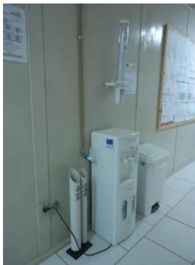
Figura 46 - Bebedouro instalado no canteiro administrativo, com coletor de resíduos plásticos e laudo de análise afixado na parede.
