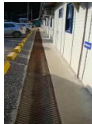
Figura 21 - Sistema de captação de água pluvial
