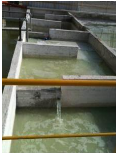
Figura 32 – Detalhe da caixa de decantação. Água conduzida para a última célula da chincana, após contato com os reagentes.
