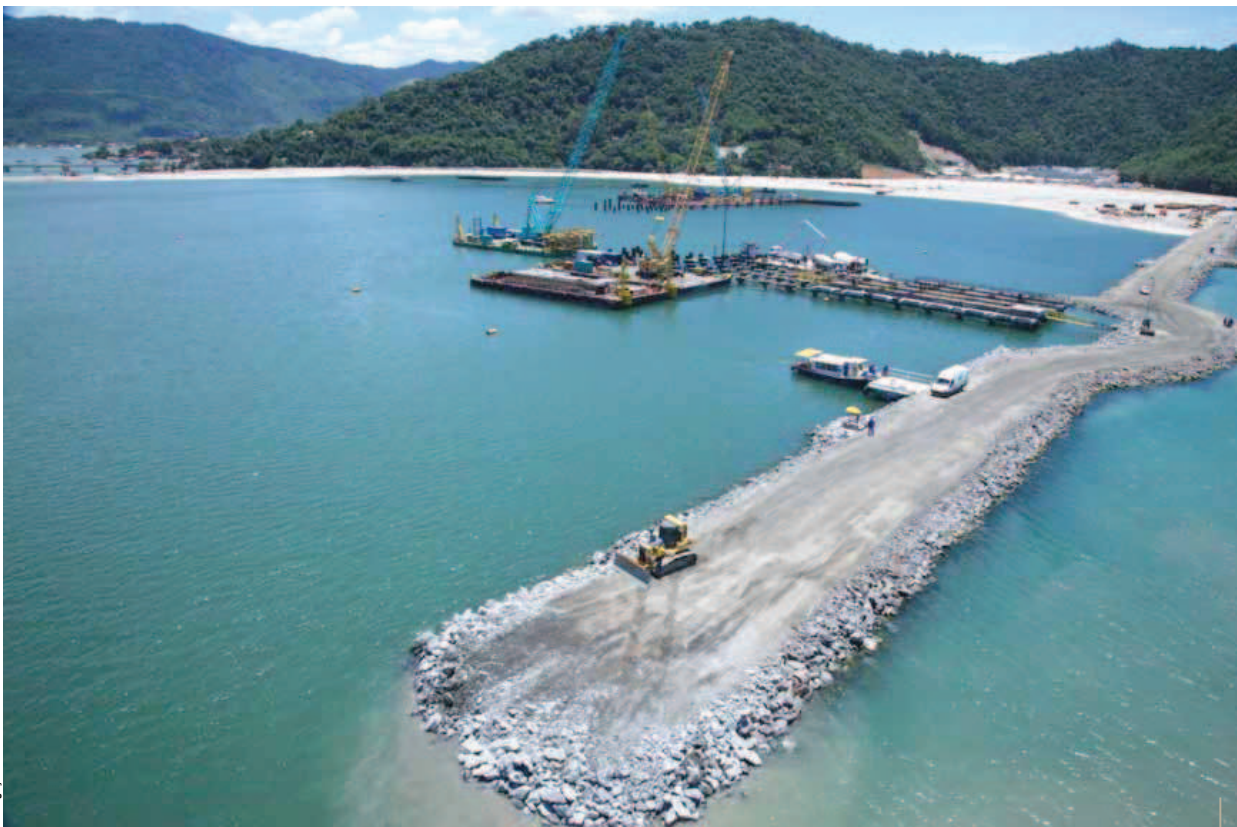
Obras marítimas na área Sul do Prosub para posterior construção do Estaleiro e Base Naval
