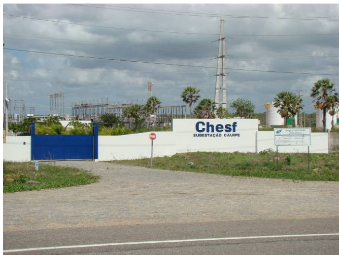
Foto 04 - Subestação Cauipe, da CHESF, situada no setor sul do CIP – Setor 4, município de Caucaia.
