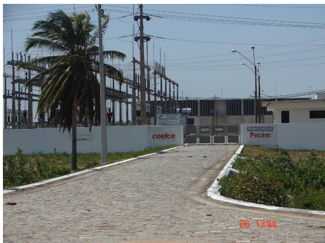
Foto 14 - Subestação da COELCE, localizada no setor norte do CIP, município de São Gonçalo do Amarante.
