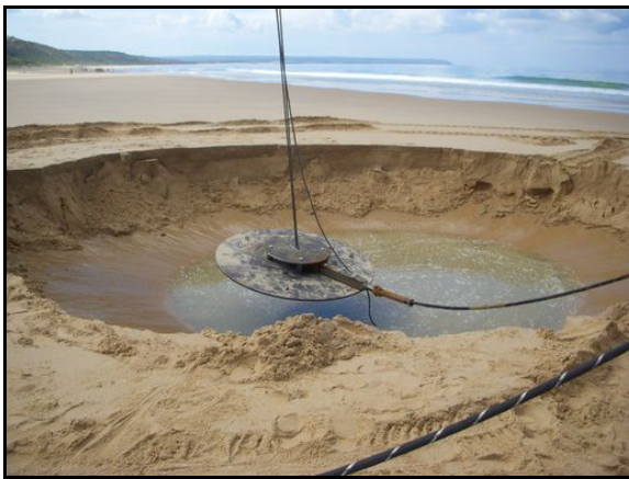
Figura III-35 - OGB - Placa de aterramento
