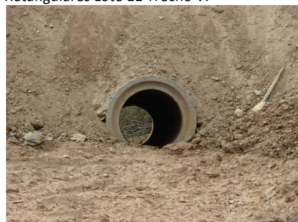
Foto 04 Galerias de Drenagem Fonte: Fonte: CEMAFAUNA
