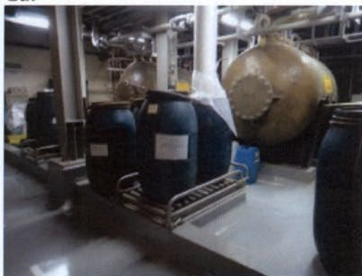
Ilustração 65 Tanques de tratamento Cal
