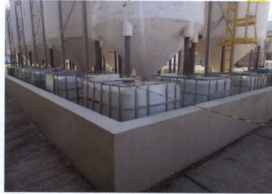
Ilustração 11: Tanques novos de armazenamento de fluoreto de amônio [2]
