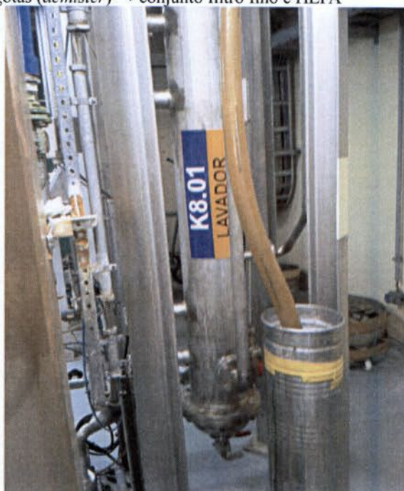
Lavador de gases
