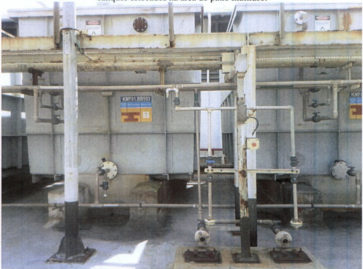
Tancagem contendo fluoreto de amônio para o processo de secagem. Não há presença de água de chuva no dique. Há a necessidade de colocar cobertura.
