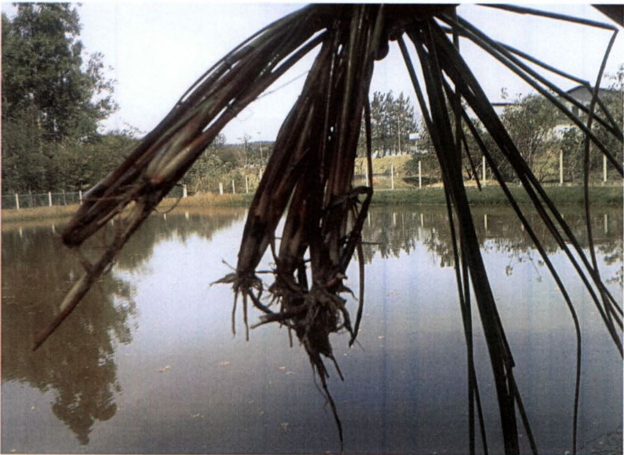
Raízes das macrófitas encontradas nas margens da lagoa, que podem comprometer a manta impermeabilizadora.
