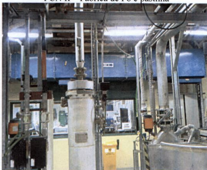
Tubulação de exaustão da fábrica (SAD 17, em azul). A sequencia do possível urânio vazado ao meio ambiente consiste em: SAD17 → lavador de gases → eliminador de gotas ( demister ) → conjunto filtro fino e HEPA
