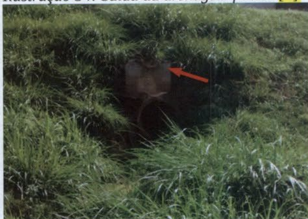
Ilustração 34: Saída da drenagem fluvial [4]
