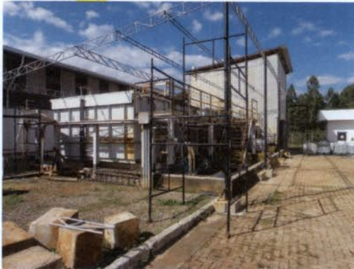
Ilustração 12: Tanques antigos de armazenamento de fluoreto de amônio. [2]
