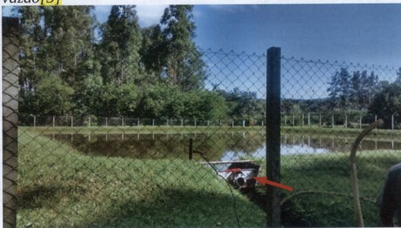
Ilustração 37: Lagoa de polimento; válvula de controle de vazão [5]
