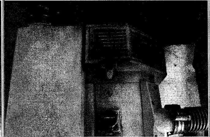
Figura 73: Sistema de exaustão de gases.
